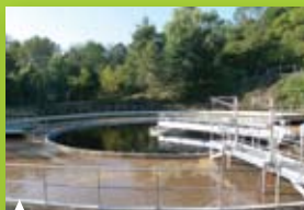
03 Le chenal d'aération et le clarificateur concentrique
