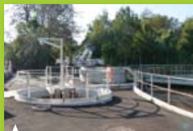
01 Le poste de relevage
