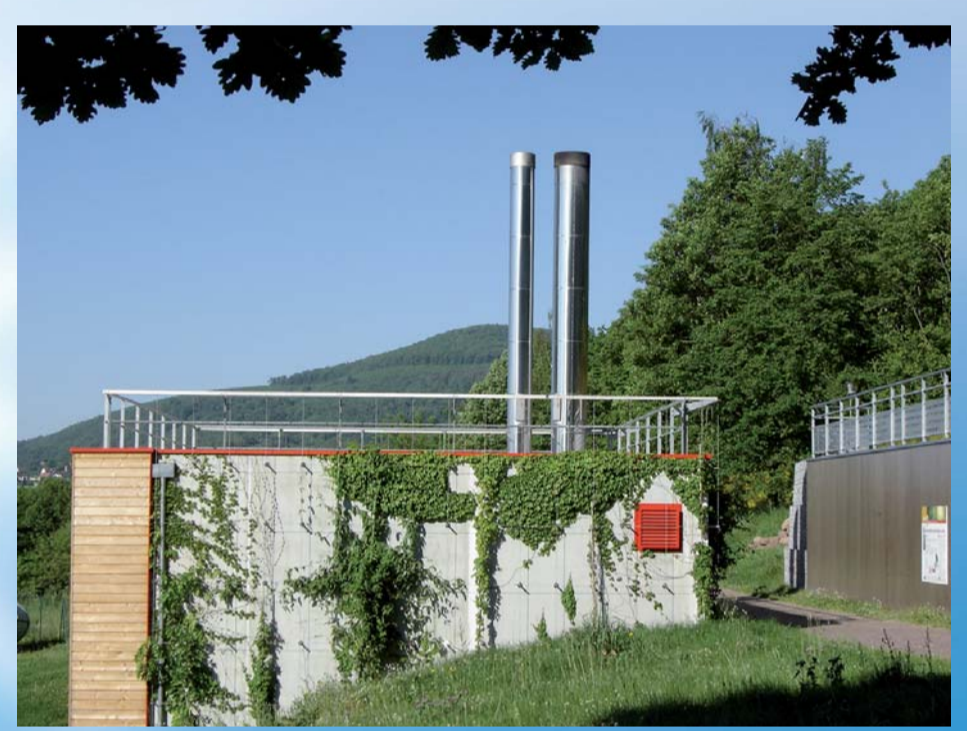
La chaufferie bois, qui dessert une dizaine de bâtiments dont la piscine, contribue de manière significative à la réduction de la pollution de l'air.
